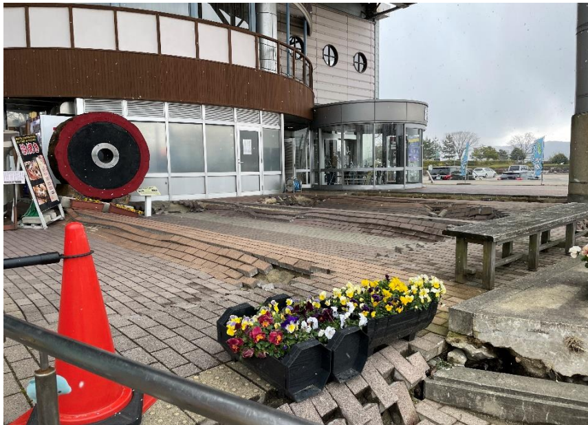
七尾市内 被害状況
