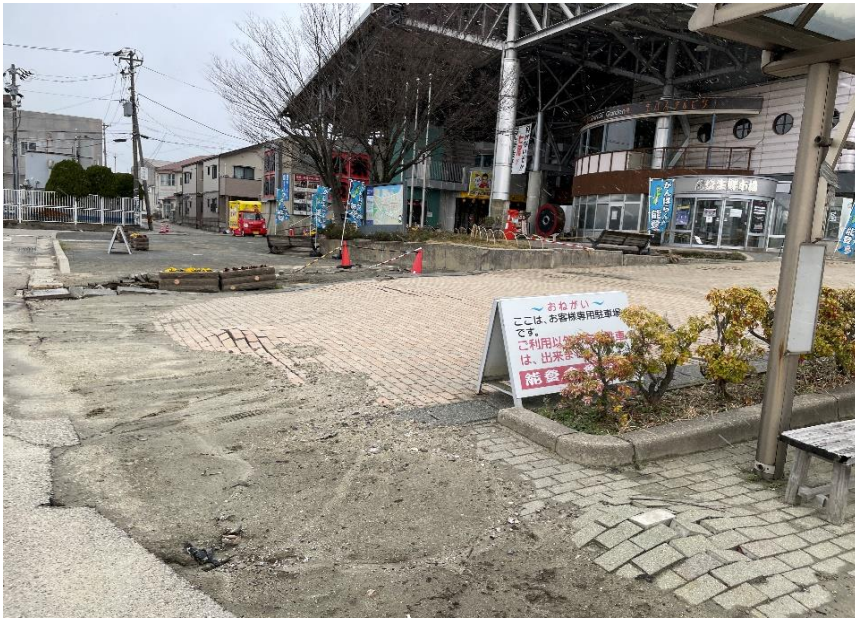
七尾市内 被害状況
