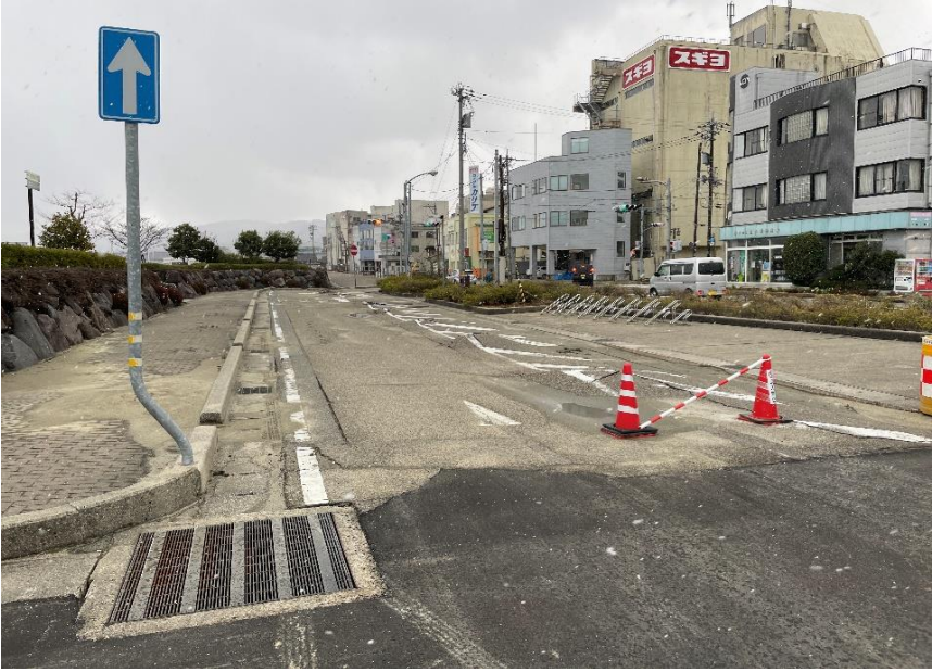
七尾市内 被害状況
