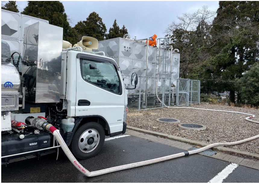
貯水槽への給水 (七尾市内 医療施設)
